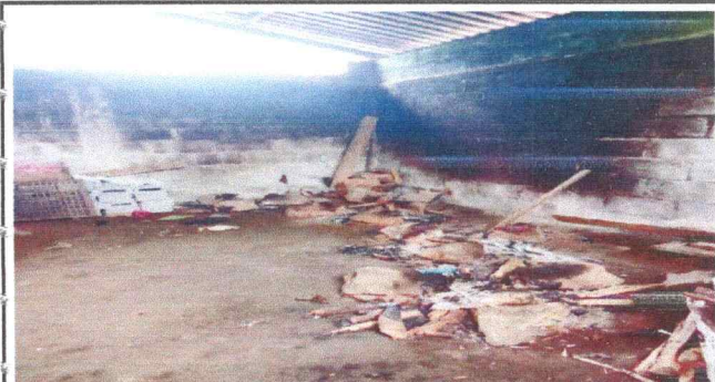
Foto 4: EN ESTA FOTOGRAFIA SE LOGRA OBSERVAR QUE LA COCINA LE FALTA PISO, POLLETON Y P.L.A.
