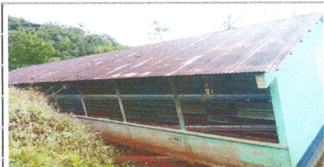
Foto 5: EN ESTA FOTOGRAFIA SE LOGRA OBSERVAR EL MAL ESTADO DE LAS VENTANAS.
