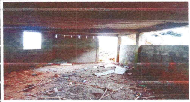
Foto 2: EN ESTA FOTOGRAFIA SE LOGRA OBSERVAR EN UNO DE LOS MODULOS QUE ESTA AULA LE FALTA VENTANAS, PISO Y PUERTA.
