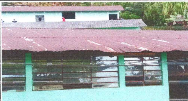
Foto 1: EN ESTA FOTOGRAFIA SE LOGRA OBSERVAR EL DETERIORO DE LAS LAMINAS DEL TECHO DE UN MODULO.
